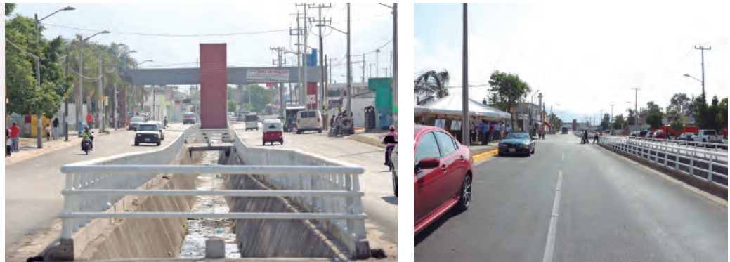
► Obra de reencarpetamiento e instalación de protecciones Boulevard Brasil y Boulevard Chulavista
